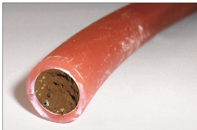
Inkrustácia spôsobená železnou baktériou v PE rozvodoch.
