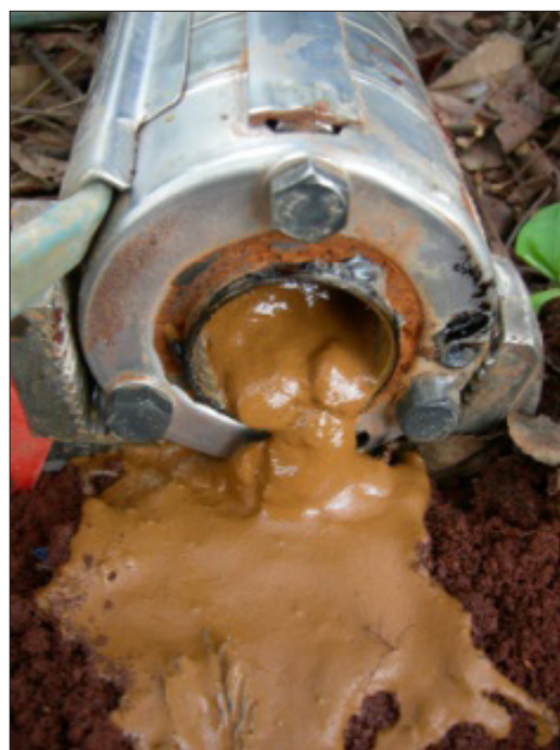
Inkrustácia spôsobená železnou baktériou v kovových rozvodoch.
