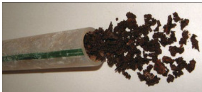
Inkrustácia spôsobená železnou baktériou v PP-R rozvodoch.
